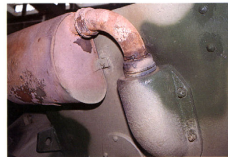
排気管とマフラー Exhaust pipes and muffler.
